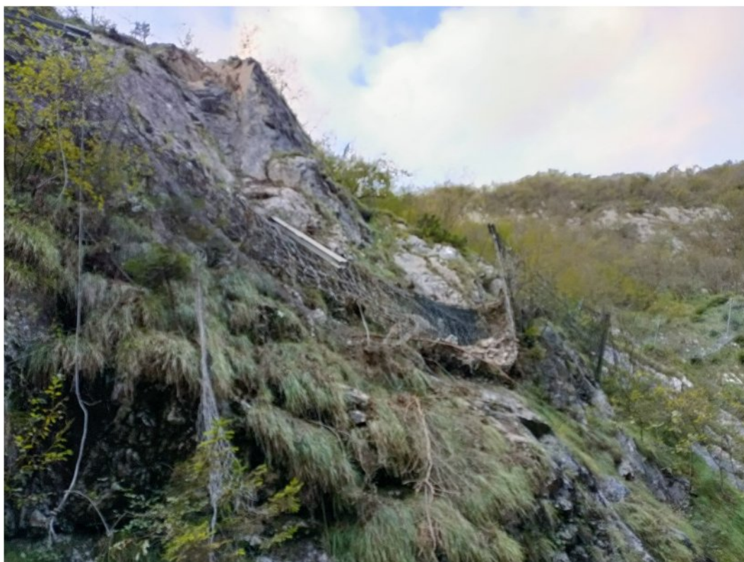
Vista da basso del punto di distacco inferiore e della barriera danneggiata.
