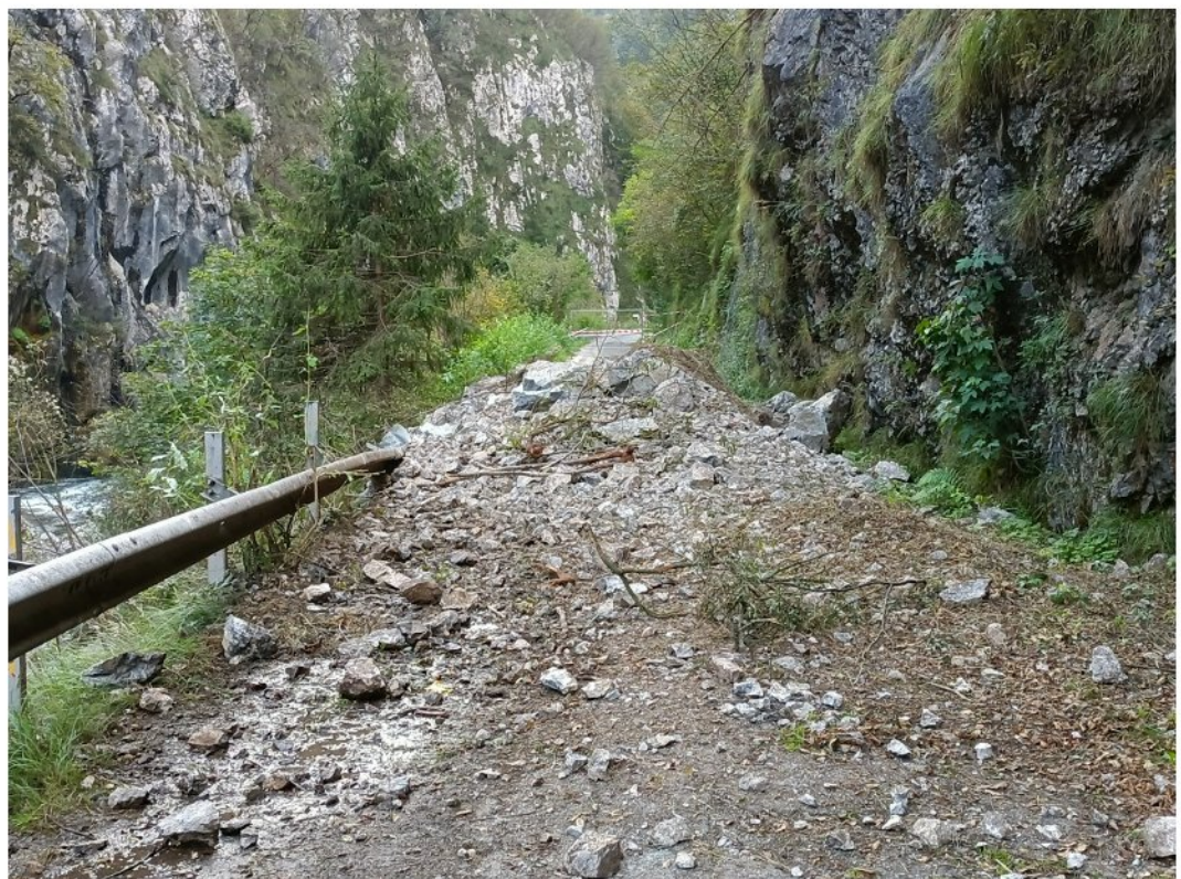
Vista, dal lato di monte della strada, del materiale franato che si accumulato sulla sede stradale.
