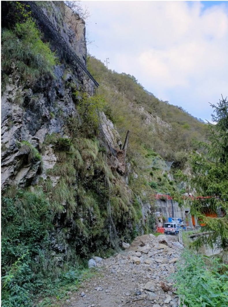
Vista, dal lato di valle della strada, del punto di distacco inferiore, della barriera paramassi danneggiata e del materiale che si è arrestato sulla sede stradale.
