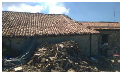
Esempi di situazioni problematiche
