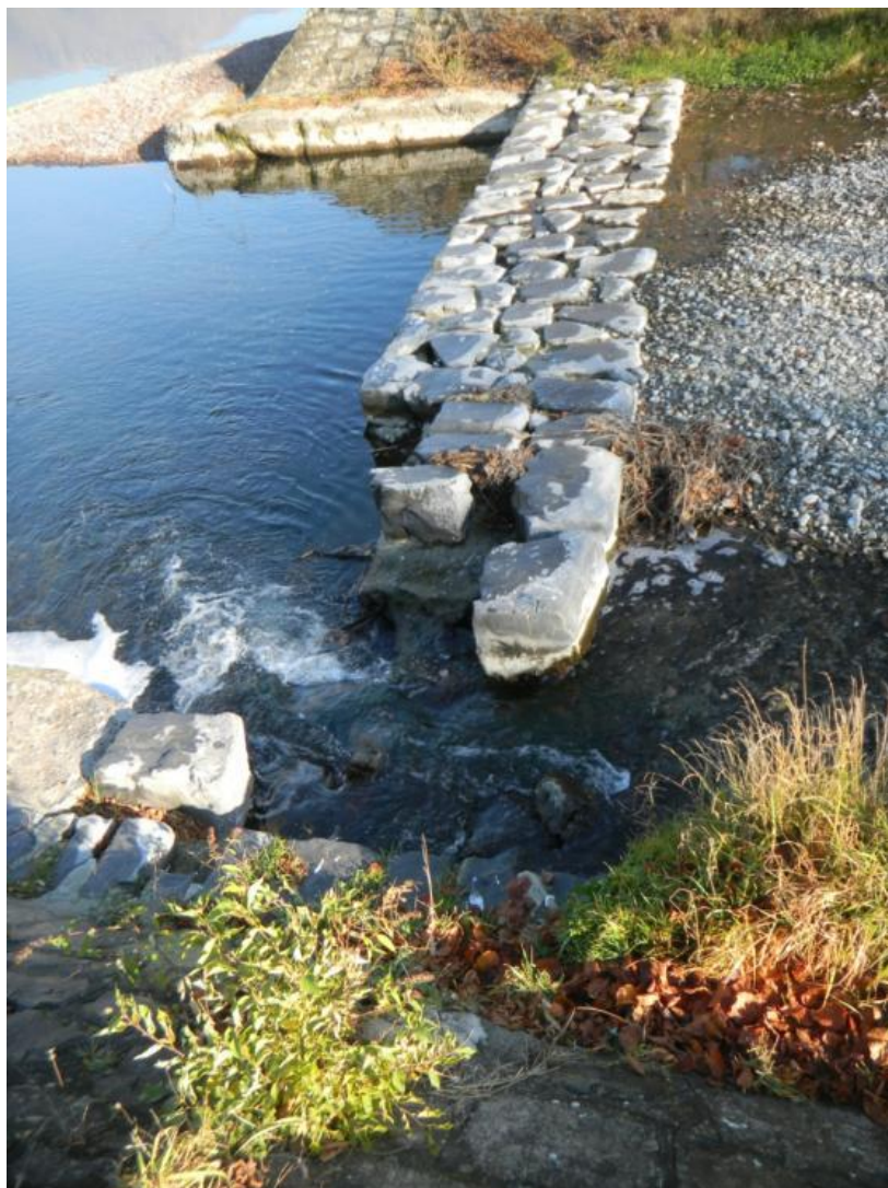
Fig. 3 soglia da ripristinare
