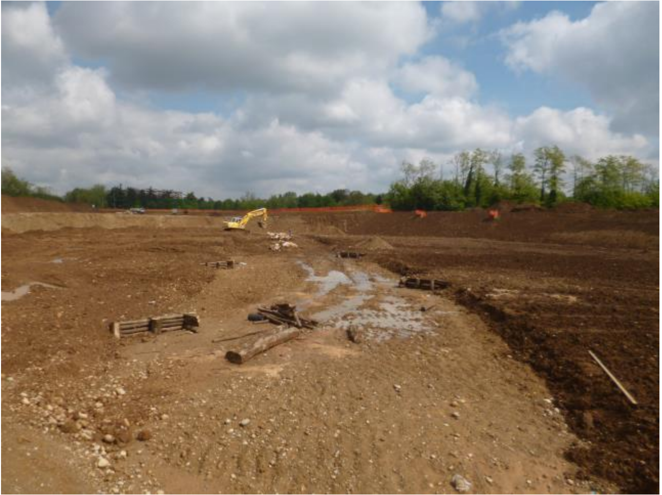
Opere in legno all'interno del nuovo alveo di magra del Guisa all'interno della vasca
