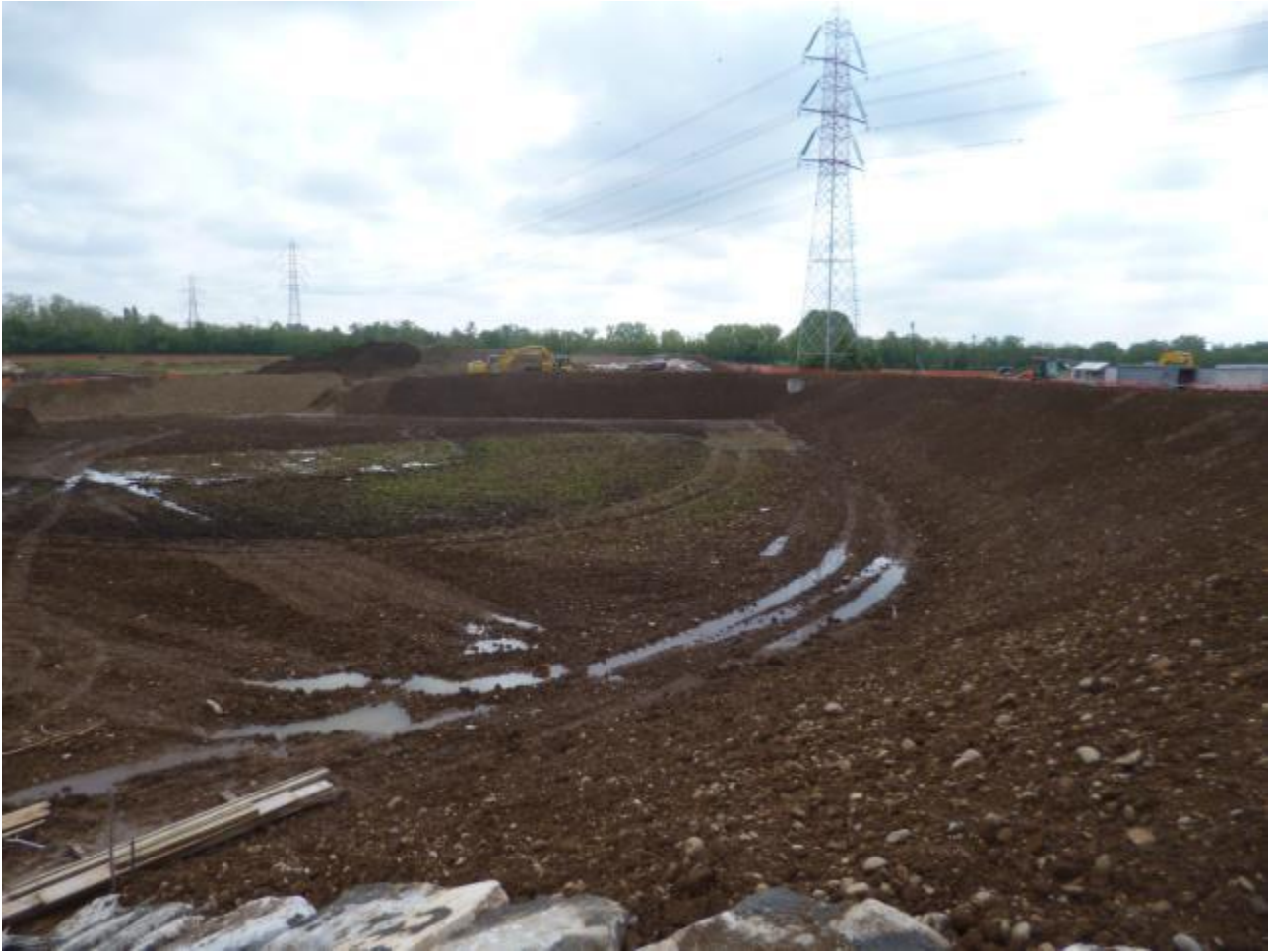
Vasca di comparto vista dal manufatto di regolazione
